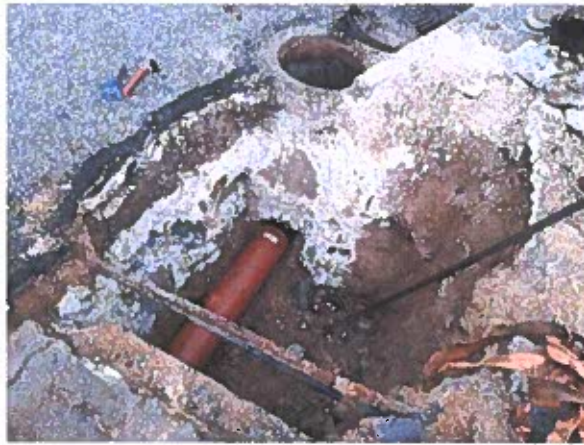
Figura 6. - Abertura junto à caixa de visita de jusante
